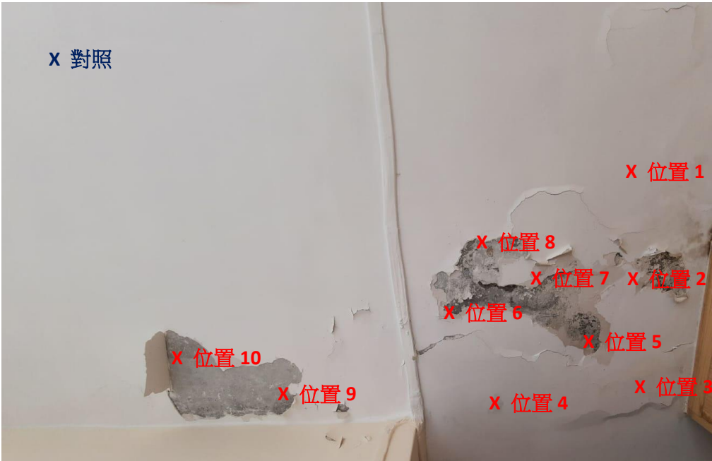
怀疑渗水位置二)： 客厅天花 (图片例子)
