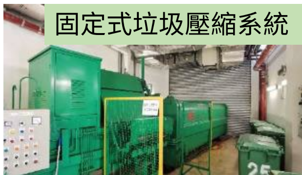
垃圾斗沒內置壓縮系統， 垃圾房設固定壓縮系統
